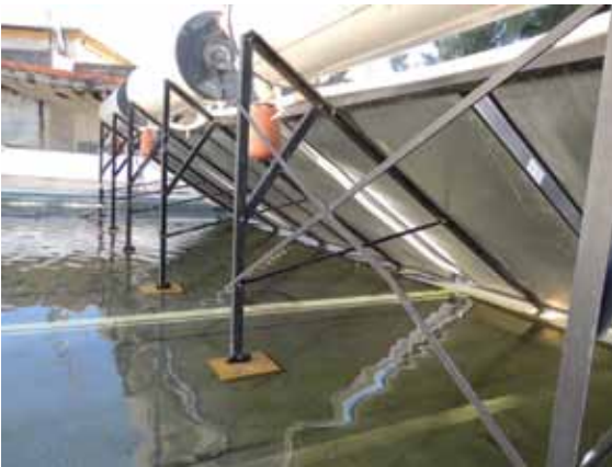
Überschwemmung auf dem Dach
