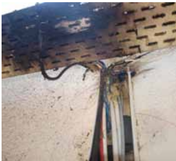
Elektrobrand an einer Klimaanlage
